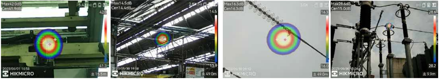
Detección de fuga de gas
