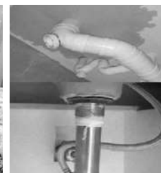
Fuga en el suministro de agua/ Fuga de tubería de agua
