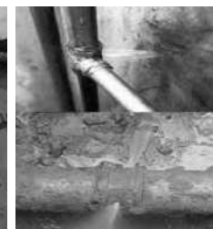
Sistema de rociadores contra incendios
