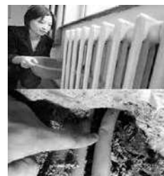
Tuberías de calefacción/fugas en tuberías de calefacción por suelo radiante
